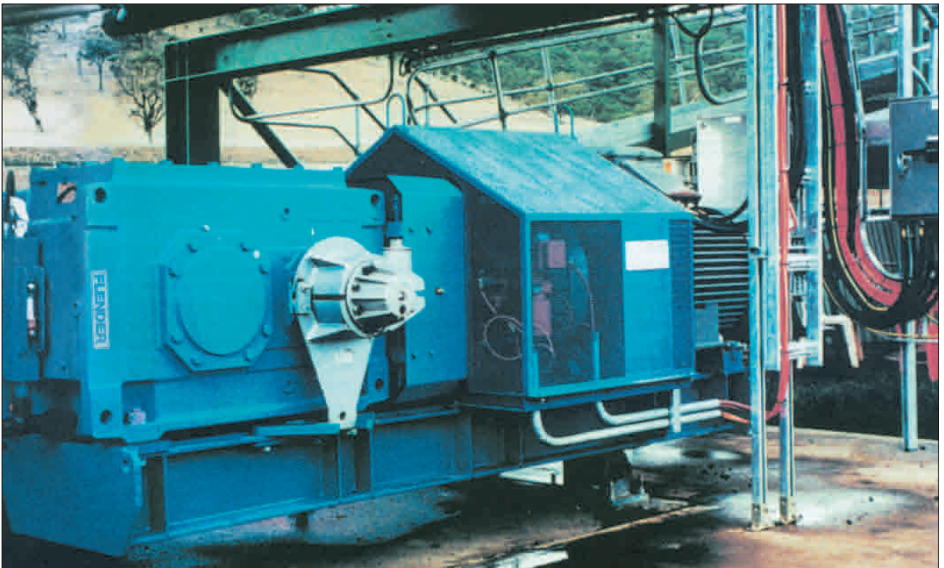
Gurtförderantrieb mit FLENDER-Kegelstirnradgetriebe B2SH Größe 12 (P = 220 kW) und Rücklaufsperr, Dartbrook / Australien Belt conveyor drive with FLENDER bevel-helical gear unit B2SH size 12 (P = 220 kW) and backstop, installed in Dartbrook / Australia Convoyeur à bande avec réducteur cylindro-conique FLENDER B2SH taille 12 (P = 220 kW) et antidévireur, Dartbrook / Australie
